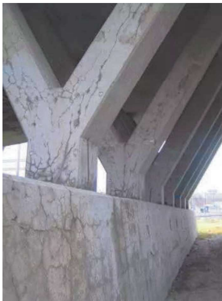
شکل ۱: آسیب دیدگی بتن در اثر انبساط سنگدانه ها [۲۰]
